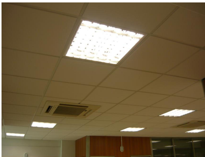
Figura 11– Luminárias e saídas de ar-condicionado Fonte: Fotografia da pesquisadora (jan., 2009)
